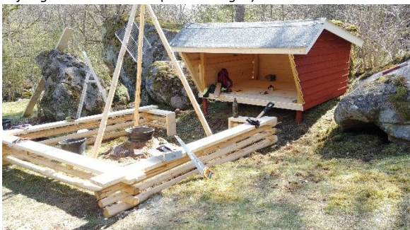
Vindskydd och grillplats vid Hjälmsadallet
